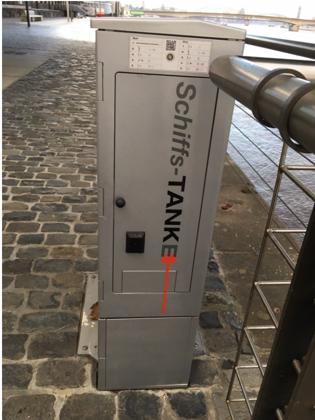
Bild 3: Eine der Stromtankstellen im Rheinauhafen
